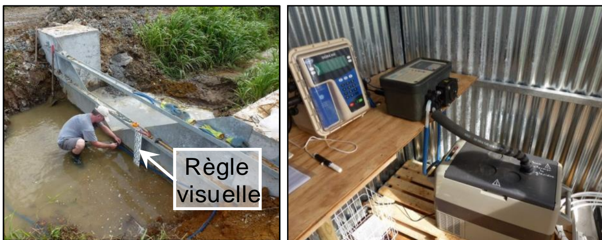
Station de mesure au Lamentin (972) : section de contrôle et préleveur réfrigéré, automatique
