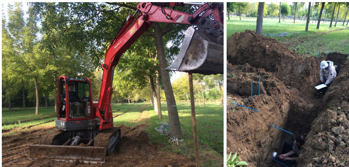
FIGURE 18 Mise en place des sondes TDR profondes en Octobre 2018.
