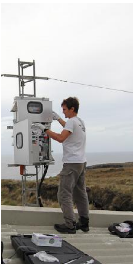
Figure 17 Unité de mesure 1130/1135 (modules extérieurs) en maintenance sur l'île d'Amsterdam (Photo :Manuel Barret).
